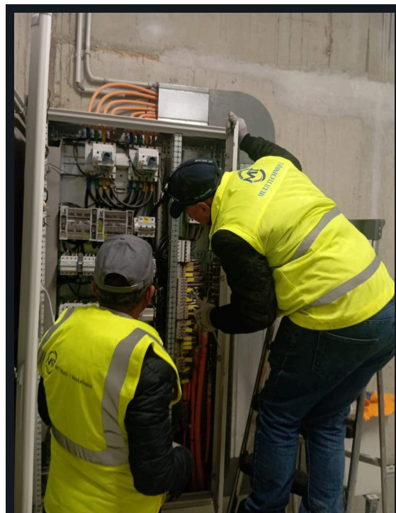
NOS TECHNICIENS EN INTERVENTION SUR UNE ARMOIRE DE DISTRIBUTION
